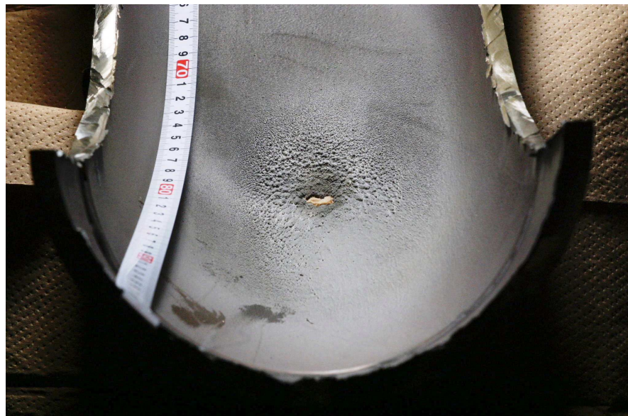
当該エルボ内面損傷状況写真（上流側から見る）
