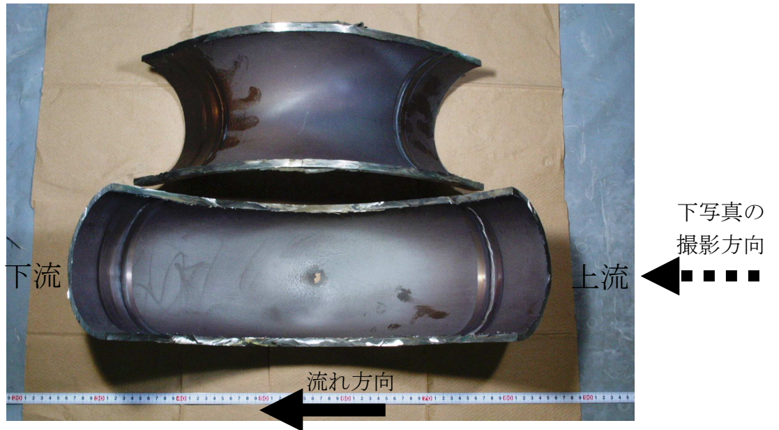
当該エルボ内面損傷状況写真
