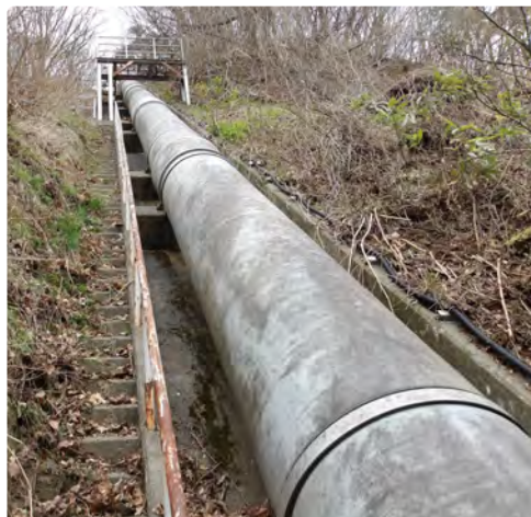
青森県内の大不動発電所のFRP水圧管路
