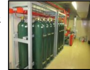
自動消火設備
