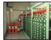
自動消火設備
