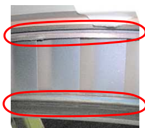
矢視B：接触② 接触状況（低圧タービン静翼）
