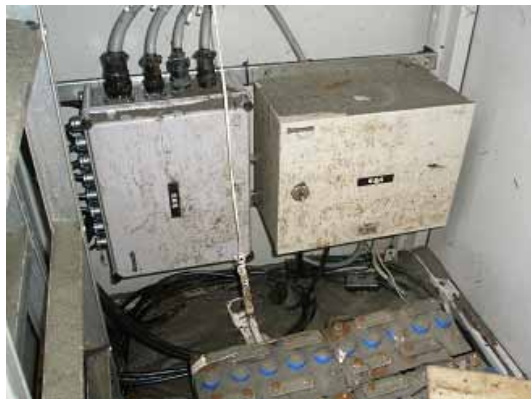
海水温度モニタリング装置 （データ伝送装置）冠水状況
