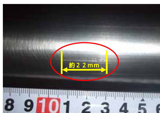
弁棒傷状況写真
