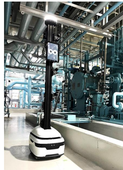
《自動巡回するロボットの様子》
