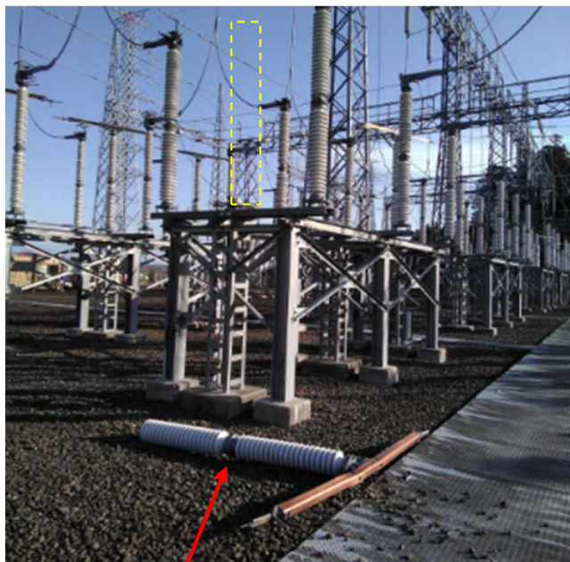
154kV 断路器 ブッシング折損
