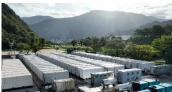
湯沢データセンター（写真提供：株式会社GXテクノロジー）
