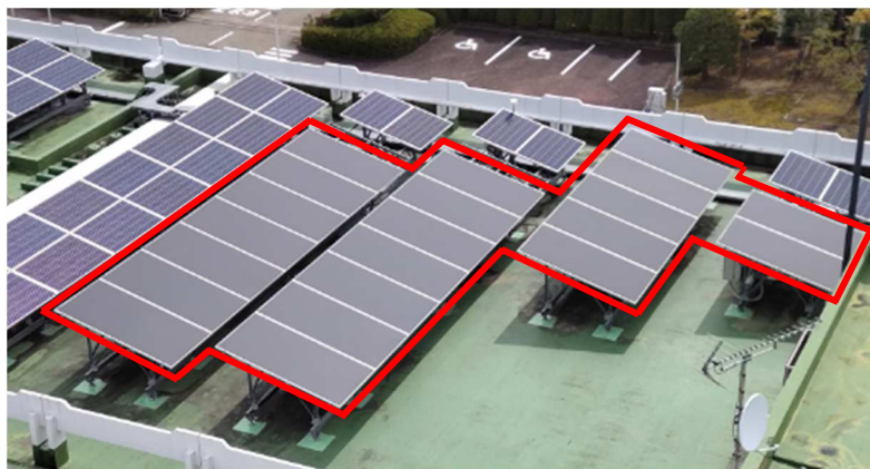
研究開発センター屋上に設置したガラス型ペロブスカイト太陽電池（写真赤枠内）
