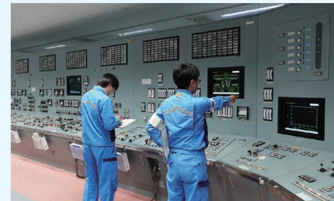
「総合負荷性能検査」でデータを記録する発電所員（6月9日）
