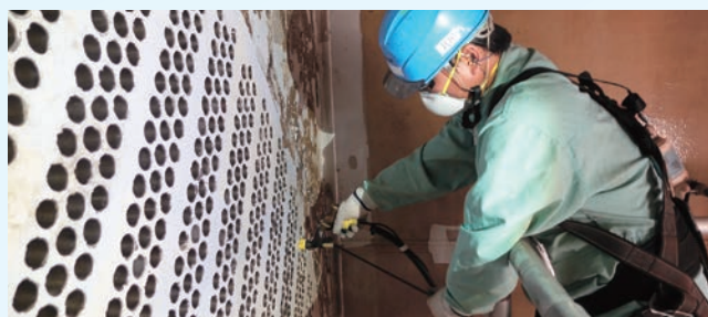
復水器細管の内部の点検 （約27,000本の細管全数の健全性を確認）
