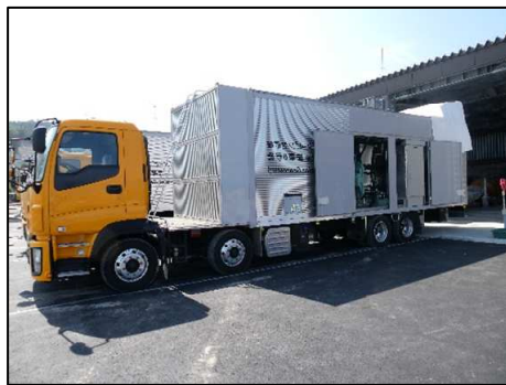
ガスタービン発電機 (A) の外観
