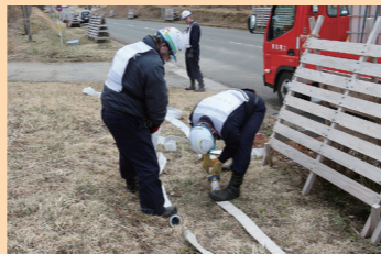
ホース同士が確実に接続されているか確認しながら作業します
