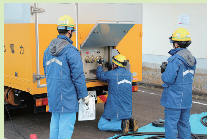
所内の電源を確保するため、電源車を接続
