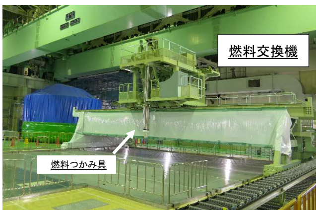
燃料交換機 全景写真
