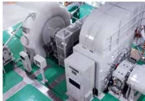
主要設備を更新（水車発電機を2台から1台に統合）した木戸川第一発電所（水力）
