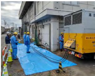
電源車接続訓練 【自治体】
