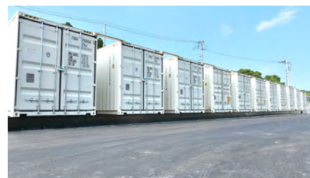
当社の遊休地に新設した コンテナ型データセンター「宮城AIデータセンター」
