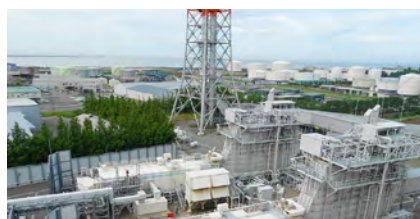
新潟火力発電所5号系列全景
