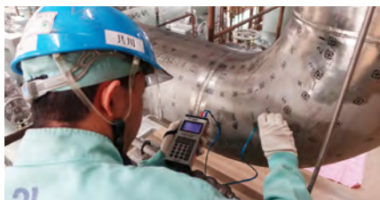
超音波厚さ測定器を用いて、配管の肉厚を測定
