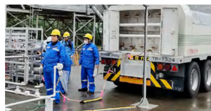
水素トレーラーから水素を供給
