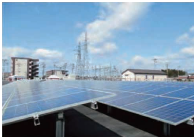
石巻蛇田太陽光発電所(宮城県石巻市)
