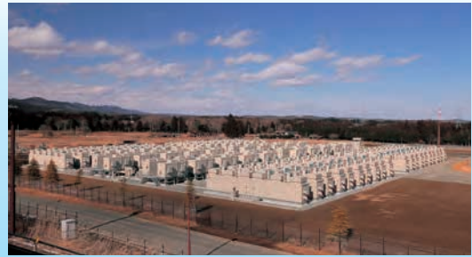
南相馬変電所 蓄電池システム
