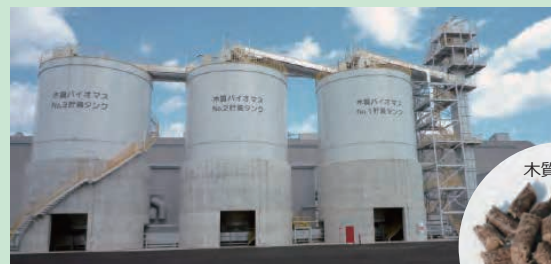
木質バイオマス燃料設備
