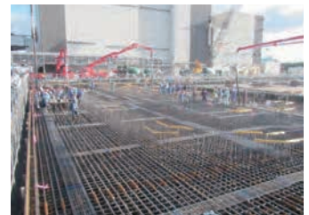
能代火力発電所3号機基礎工事でのコンクリート大量打設の状況
