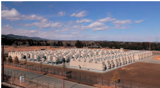
南相馬変電所 蓄電池システム
