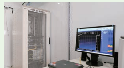
系統安定化制御装置
