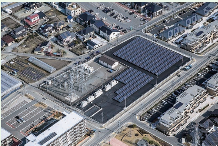
石巻蛇田太陽光発電所
