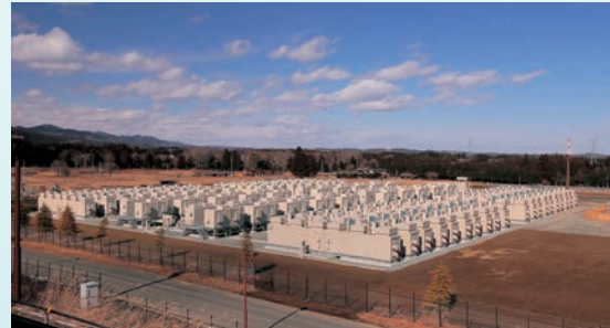
南相馬変電所 蓄電池システム
