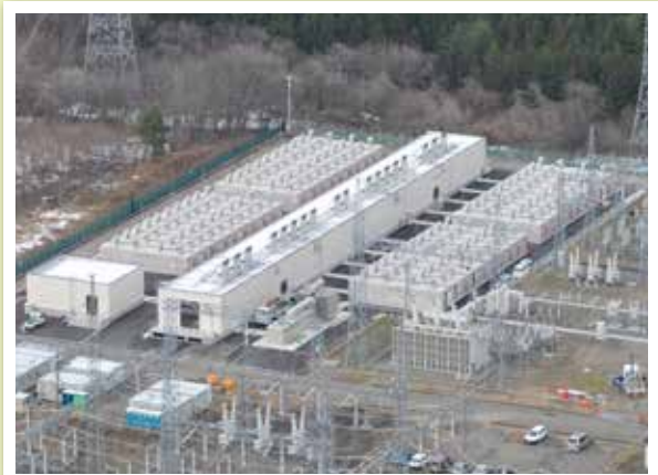
西仙台変電所 蓄電池システム
