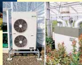
施設園芸用ハウスへのヒートポンプ導入事例
