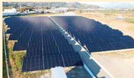
2013年12月に営業運転を開始した白石太陽光発電所(東北ソーラーパワー株式会社/宮城県白石市)
