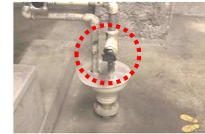
ドレントラップ部
