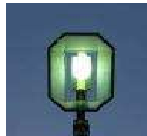
駐車場照明例
