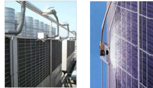
室外機散水装置
