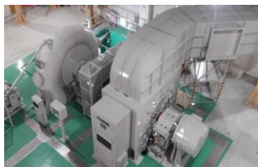
木戸川第一発電所(水力)
