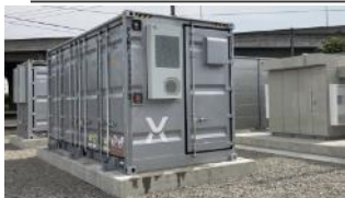
小角田蓄電所 (写真提供: 坂東蓄電所1号合同会社)
