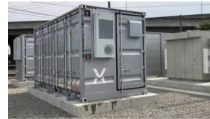
小角田蓄電所
