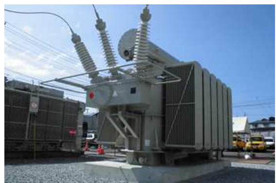
図3 新型環境調和型変圧器外観(桜田変電所(山形市))
