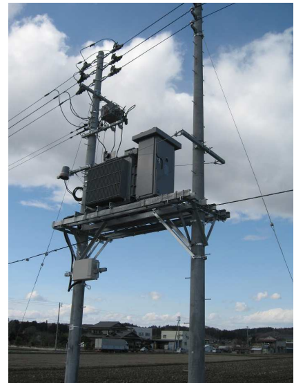
図1 磁束制御型高圧電圧調整装置MAVICSの試験状況
