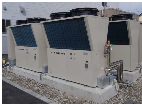
図2 寒冷地向け大容量給湯機外観 (学校給食センターに4台設置)
