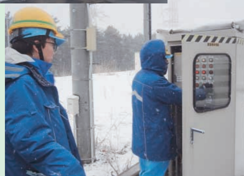
大容量電源装置の起動操作
