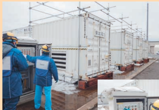
大容量電源装置から発電所設備へ電力を供給する訓練
