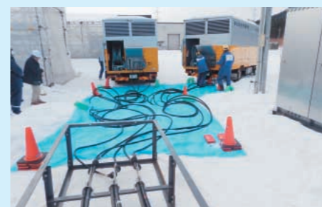
電源車による電源確保訓練
