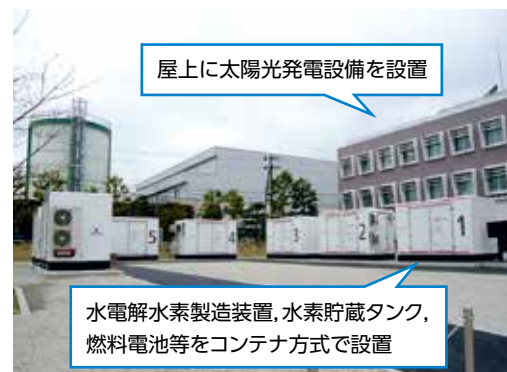
研究開発センターに設置した水素製造システム
