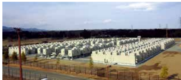
南相馬変電所大容量蓄電池システムの全景（設置面積約8,500㎡）
