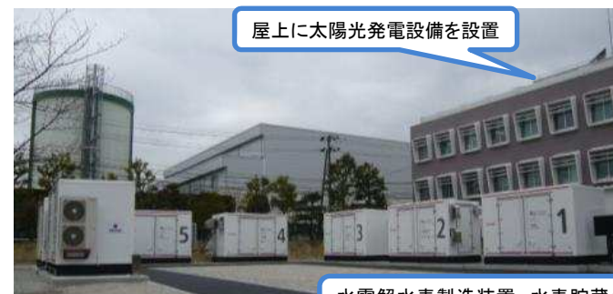
水素製造システム
