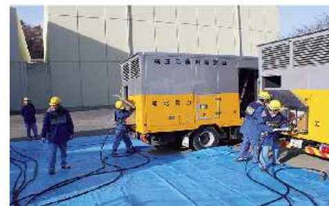
電源車の接続による電源確保訓練(女川)
