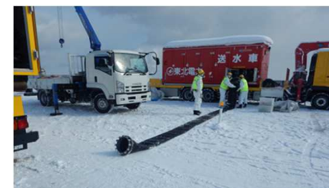
代替非常用冷却海水ポンプによる冷却機能確保訓練(東通)
