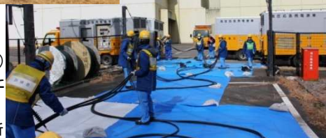
(右) 電源車を用いた電源確保訓練 写真: 女川原子力発電所
