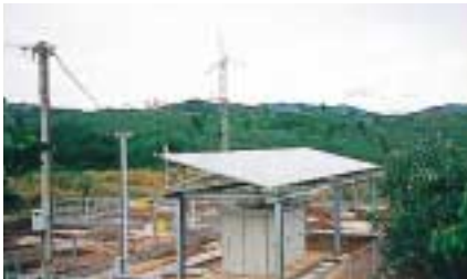
太陽光・風力ハイブリッド発電システム(ベトナム)
