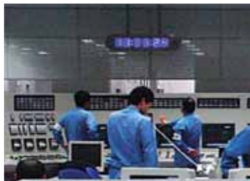
営業運転に入った東通1号機の中央制御室内
